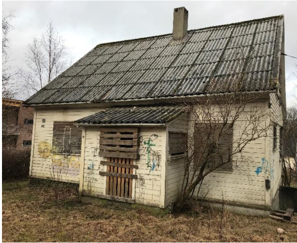
Figur 2 Våningshuset på tomten bærer preg av at det har vært ubebodd over lengre tid og manglende vedlikehold.
