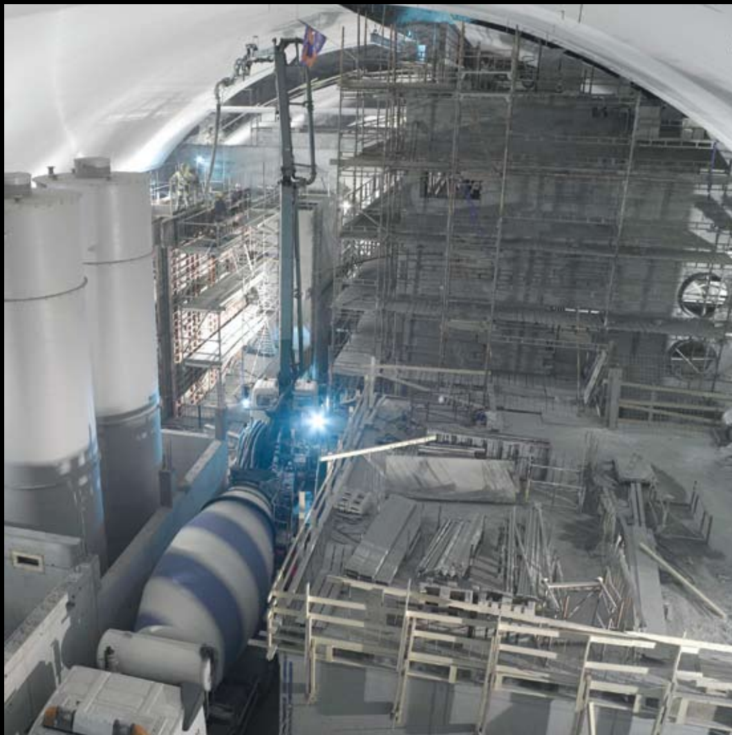
Oset, Oslo - Foto: cf - wesenberg / kolonihaven.no • Vannbehandlingsanlegg
